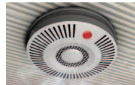
CONTROLLO RIVELATORI FUMO/GAS
