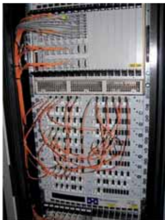
Fig. 1 – Uno dei quattro rack di misura del sistema modulare HBM Genesis HighSpeed nel Laboratorio di Alta Potenza ABB. ABB può registrare contemporaneamente i dati di un massimo di 32 canali
