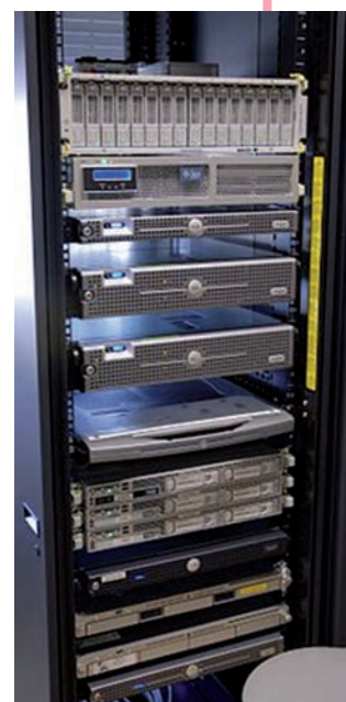
Fig. 1 - Armadio rack contenente apparecchiature server
